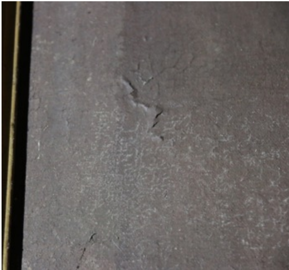
Surface picturale sale, soulèvements de l'écaillage, traces de moisissures.
